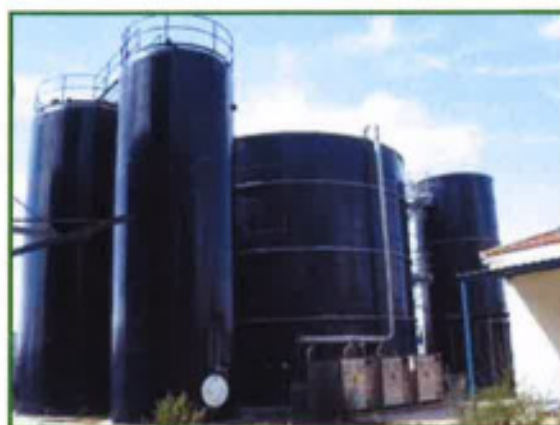
15. Depósitos del tratamiento de aguas
