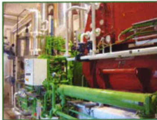
11. Turbina Siemens KKK
