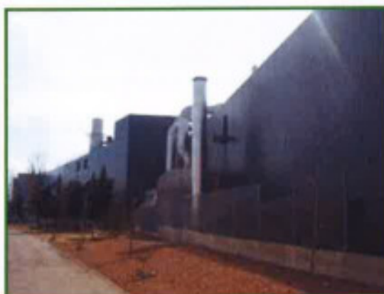
14. Tratamiento de aires (biofiltro/RTO)
