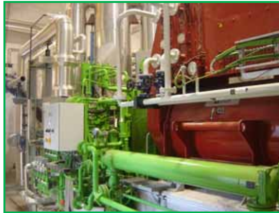
11. Turbina Siemens KKK
